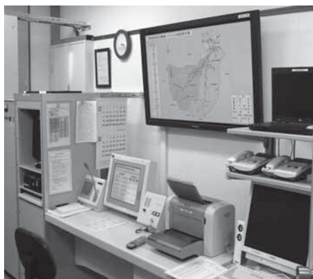
防災無線システム
