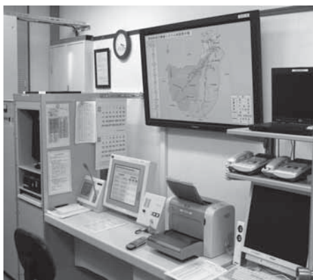
防災無線システム
