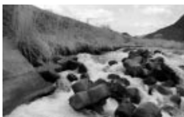
大雨により破壊された沈床ブロック
