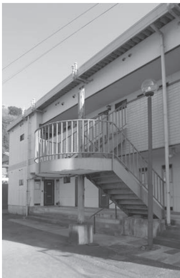
腐食が進むらせん階段
