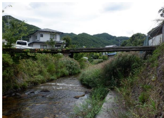
健全度 IV : 稲荷橋(橋脚の流出)
